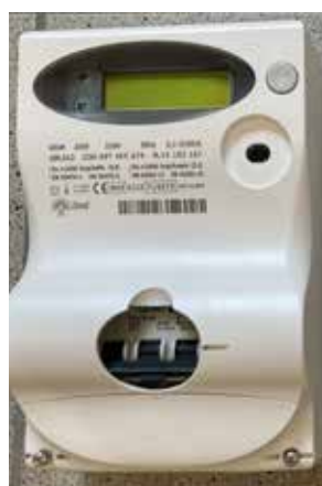
Zähler 1G – alter Zähler
